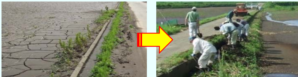
大雨により水路に堆積した土砂を地域共同で撤去（外注も可能）
