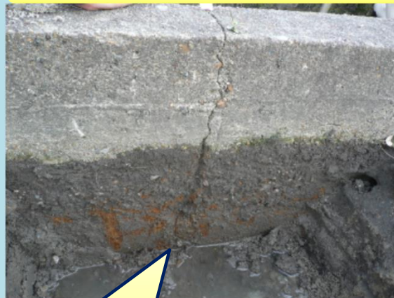
縦方向のひび割れ
