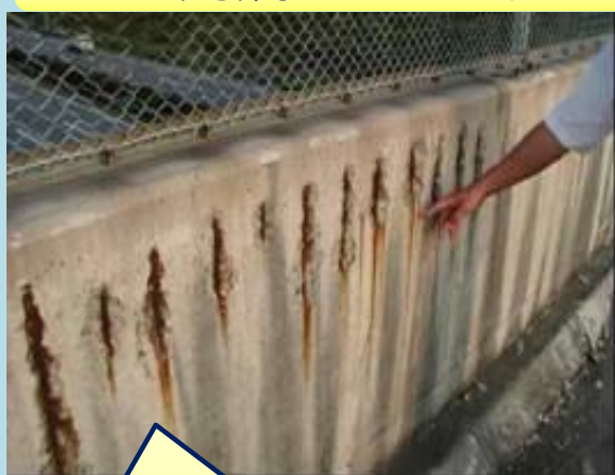
短い間隔のひび割れ
