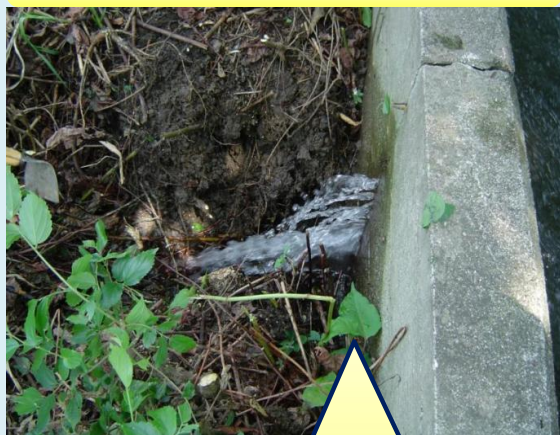
目地の開き (漏水)
