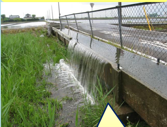
沈下による溢水
