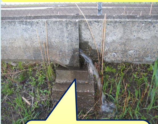
目地の開き (漏水)
