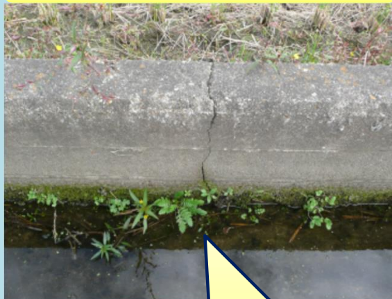
縦方向のひび割れ
