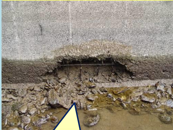
鉄筋が露出した欠損
