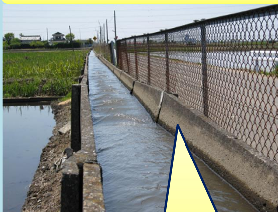
沈下による変形
