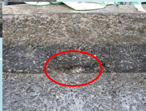
水路の壁にあいた穴
