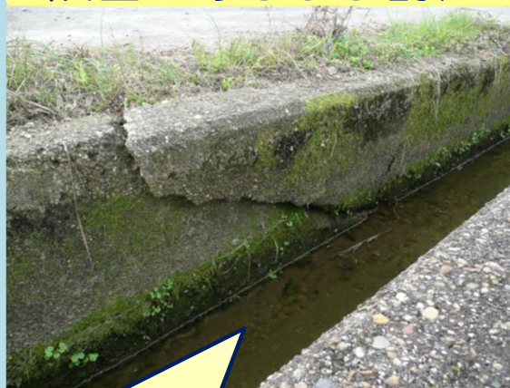
段差のあるひび割れ
