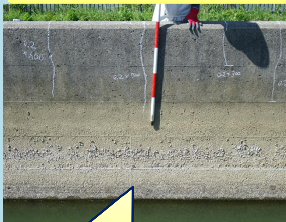
縦方向のひび割れ
