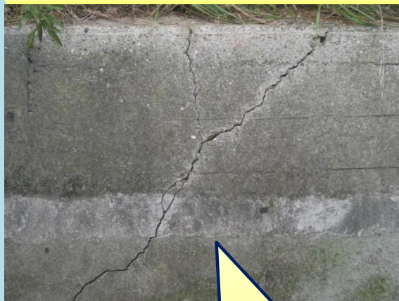
斜め方向に走る割れ
